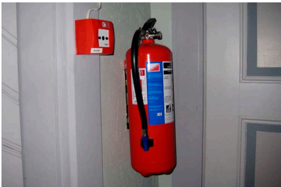
Bild kyrka 5.4: Handbrandsläckare samt alarmtryckknapp.
