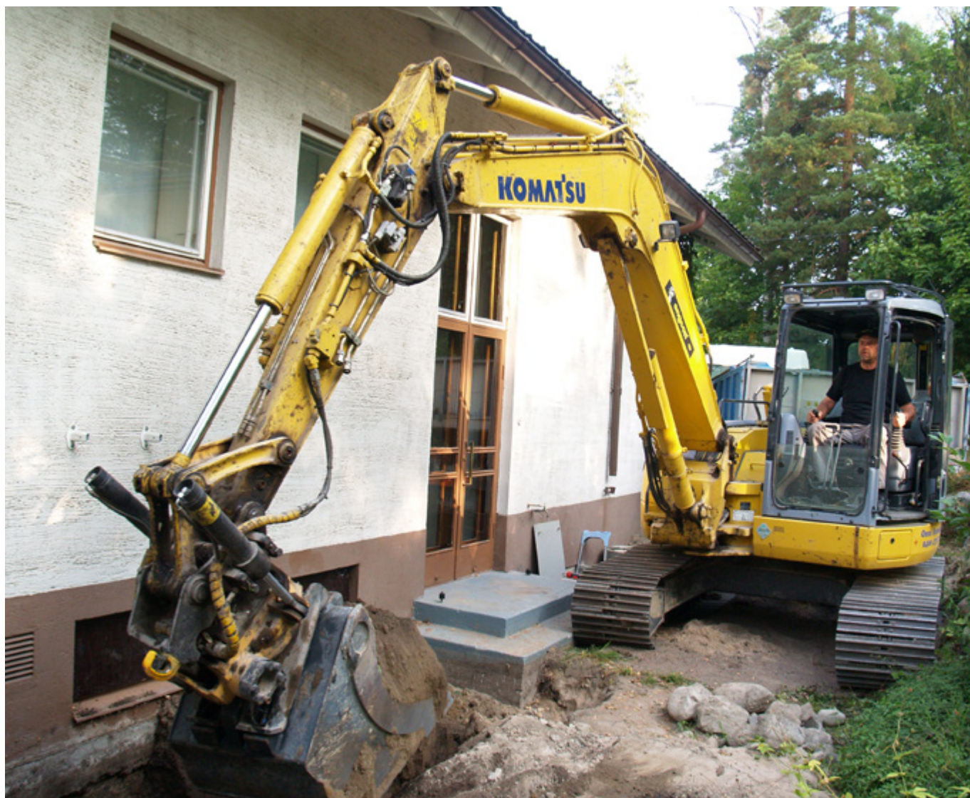
En förhöjd fukthalt i grundkonstruktionen kan bero på avsaknad av eller dåligt fungerande dränering.
