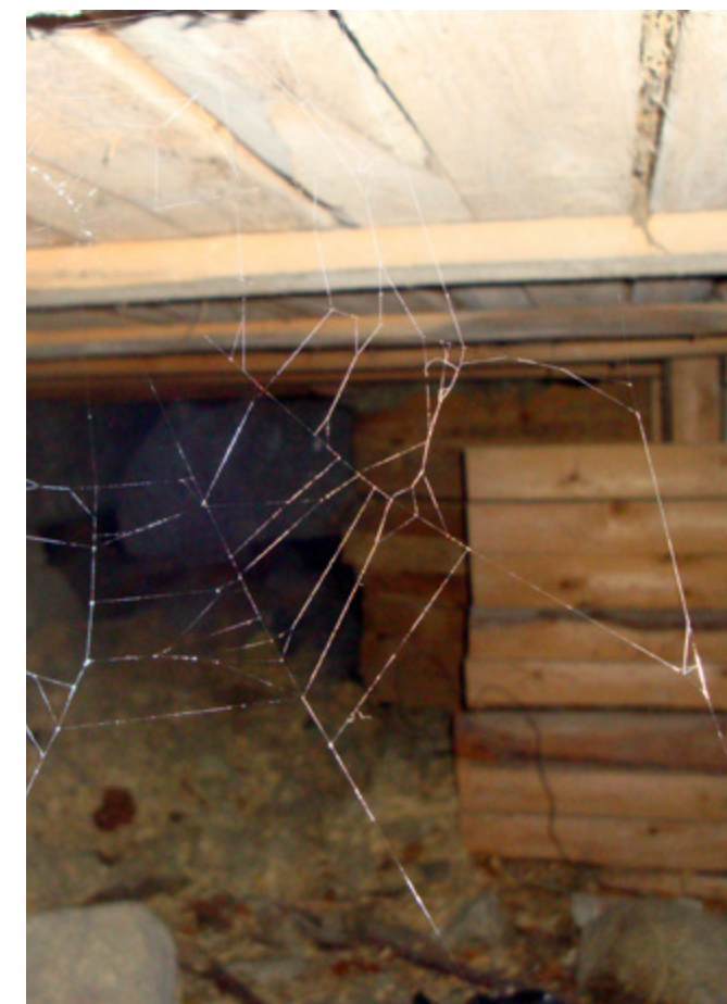
Krypgrunder är en riskkonstruktion som är vanlig i gamla trähus.
